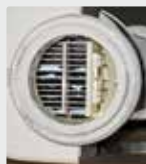
Filtro de piscina
