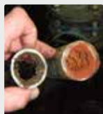
Sistema de tuberías
