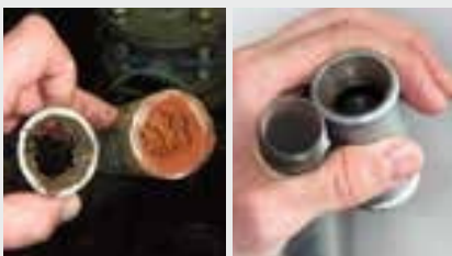
Sistema de tuberías
