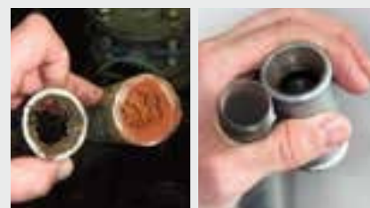
Sistema de tuberías
