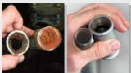
Sistema de tuberías
